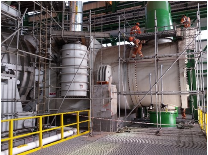
Achterzijde condensor stoomturbine Zhuhai China (door de groene leidingen stroomt 28 miljoen ltr koelwater per uur!!)
