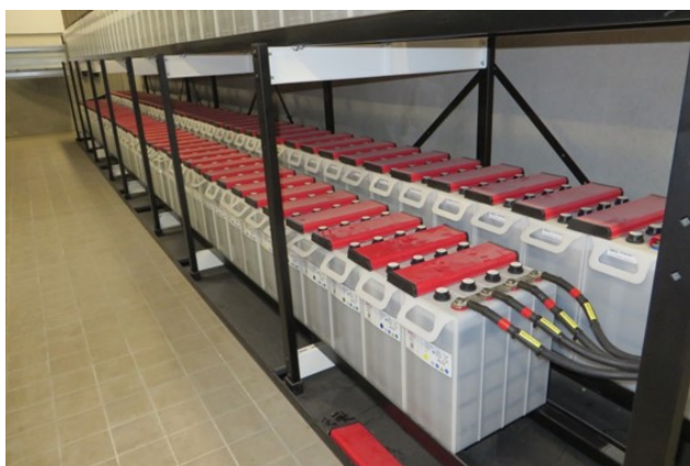
Drie van deze stellingen met accu's vullen de ruimte en dienen als noodvoorziening bij elektriciteit uitval.
